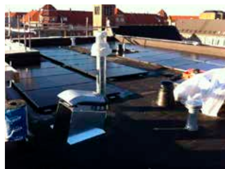
Inverter monteret på beslag udviklet af PHØNIX TAG Energi A/S. Med dette beslag kan inverteren monteres diskret og lavt på taget, så den bliver meget lidt synlig.
